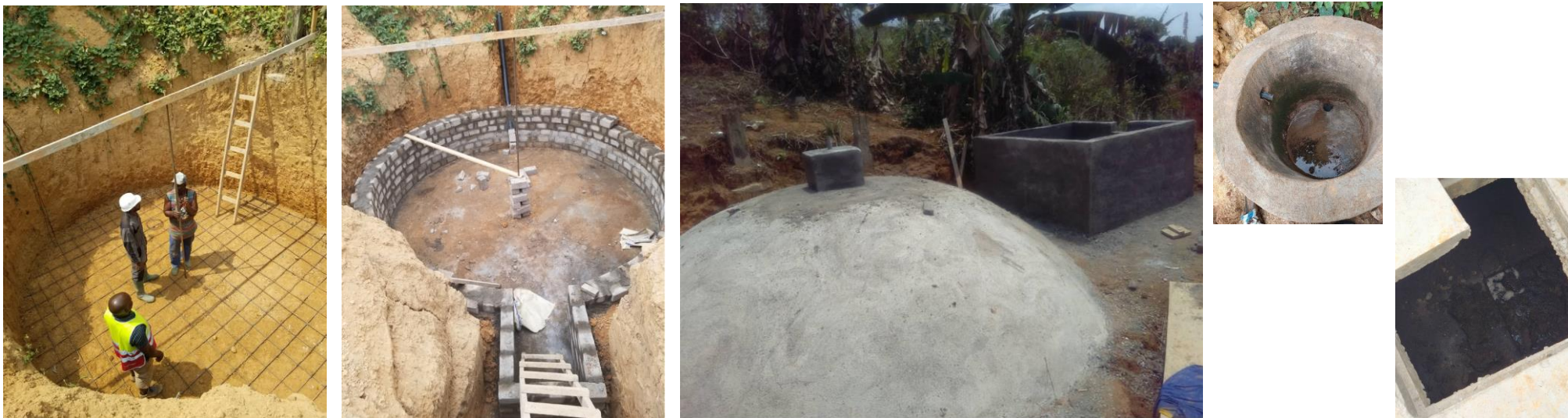
Photos 22 : Autres installations du CEFPREPAS : Biodigester en béton (20m3) pour la transformation des déchets du CEFPREPAS en Biogaz utilisé pour la cuisson
